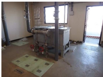
汚水計量槽・流量調整槽
