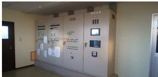
動力制御盤・計装盤
