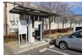
電気自動車急速充電器の更新
