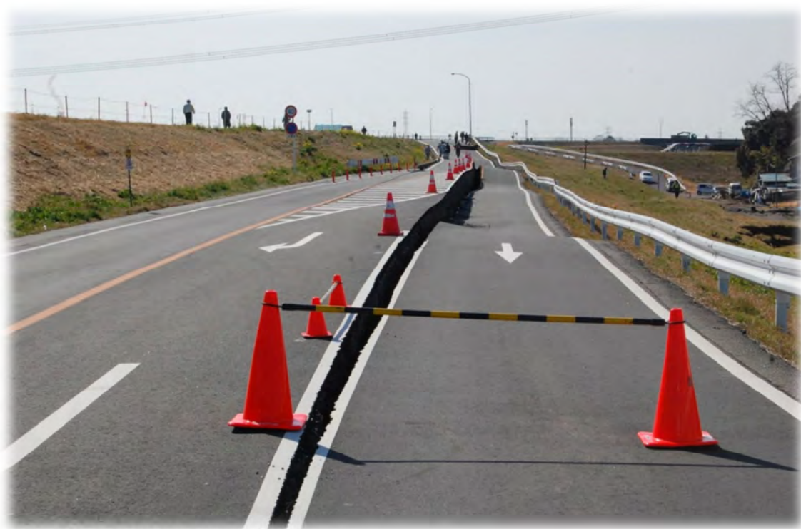
■ 東日本大震災の被害状況
