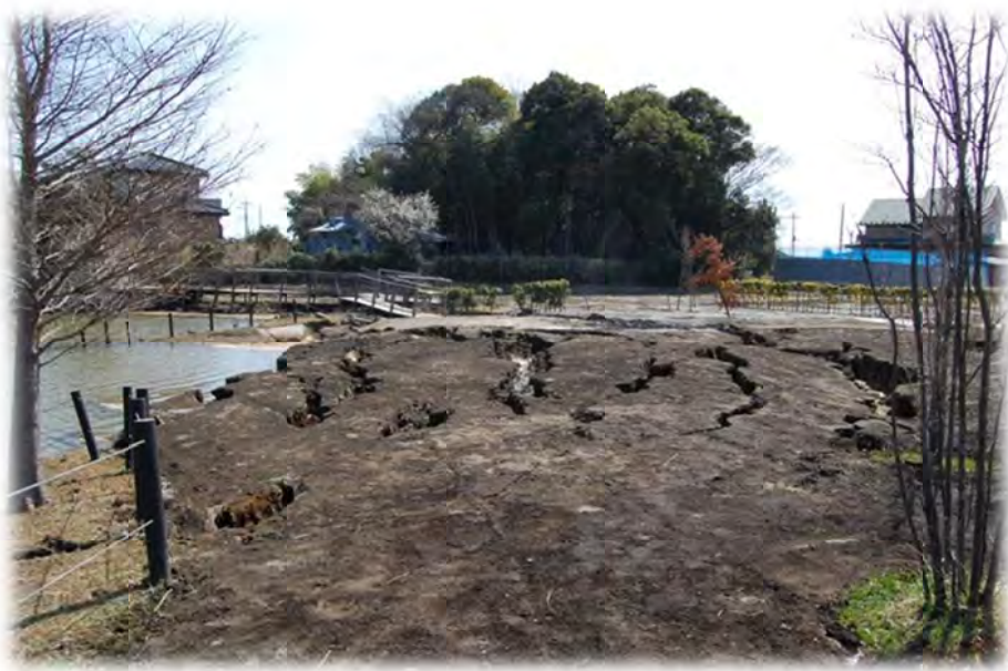
■東日本大震災における液状化（高須賀池公園）
