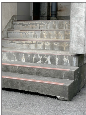
写真 1-7 地盤沈下による段差
