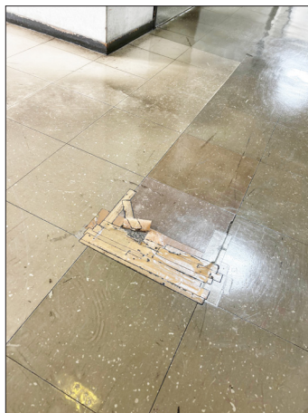
写真 1-2 床仕上げの剥離
