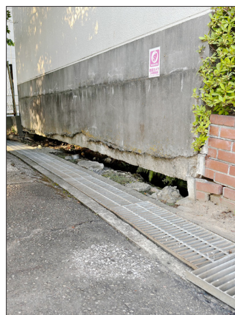
写真 1-9 庁舎と地面の隙間 2
