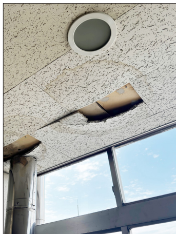
写真 1-1 天井仕上げの剥離
