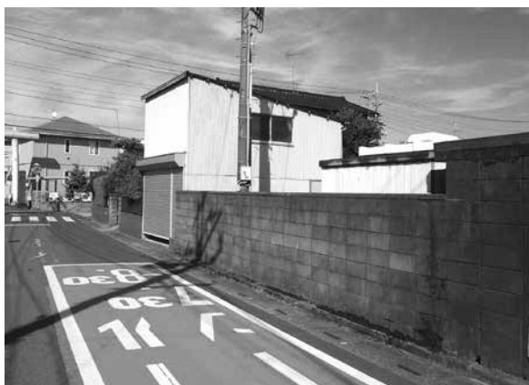
上高野小学校ブロック塀
