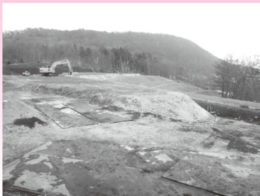
埼玉県環境整備センター
