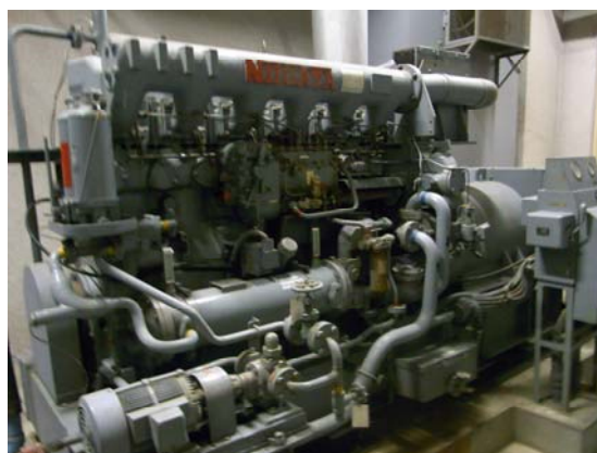
図 4-10 第2浄水場自家用発電設備
