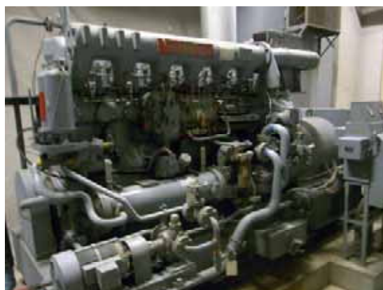
図 4-10 第2浄水場自家用発電設備
