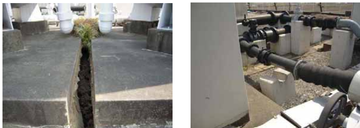
図 4-8 ろ過機基礎部の空洞(左)、基礎部の沈下(右)
