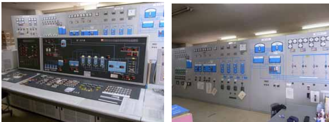
図 4-18 第2浄水場管理室内
