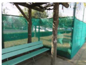
パーゴラ支柱破損・表層剥落
