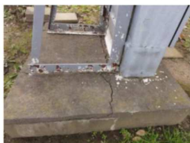
引込開閉器塗装劣化・基礎破損
