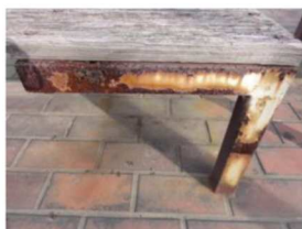
ベンチ台座全面発錆・木部腐朽
