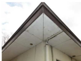
管理棟軒裏雨漏り
