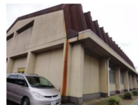
体育館屋根劣化・屋内漏水
