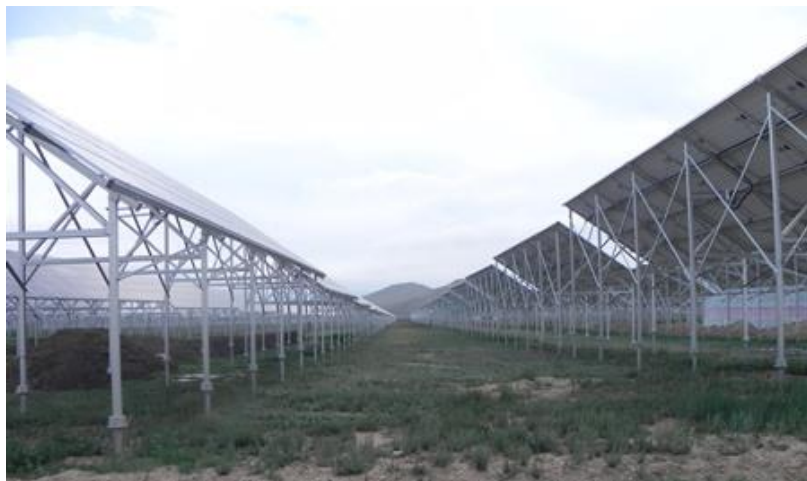
モンナラン発電所の太陽光パネル
