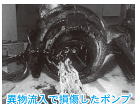
異物流入で損傷したポンプ
