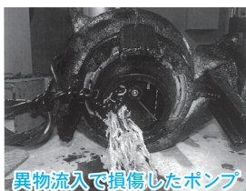
異物流入で損傷したポンプ
